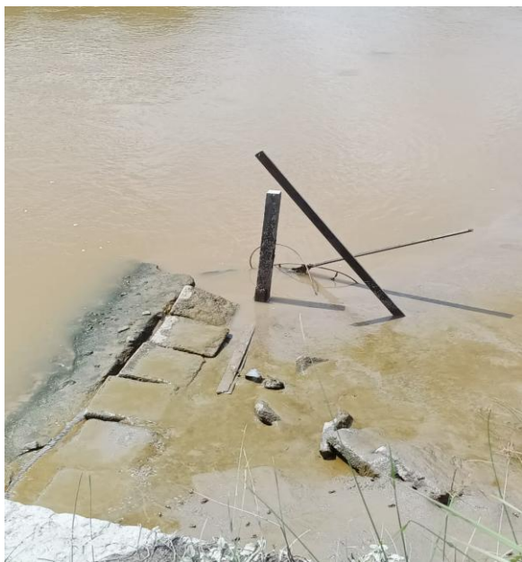
Figuur 9 Nani Sluis Peillat verwijderd / beschadigd
